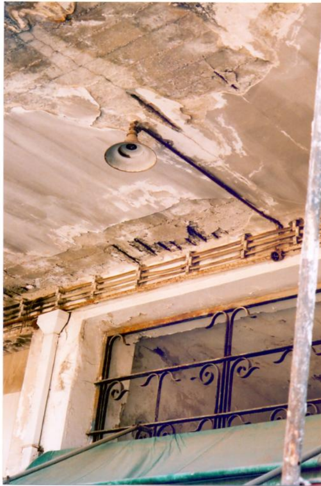
Φωτισμός του Μεσοπολέμου, που επίσης πρέπει να διατηρηθεί. Φθορές στην πλάκα του σκυροδέματος που χρειάζονται άμεση επισκευή
