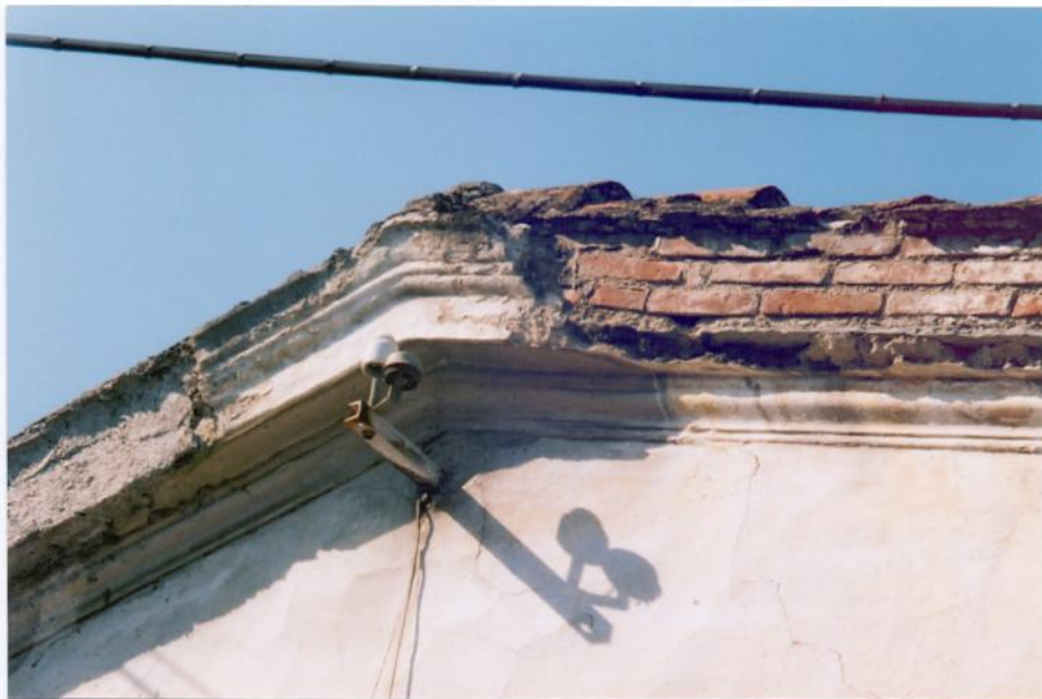
Φθορές γείσων κτηρίων του 1893, νεώτερες προσθήκες ηλεκτρικών μονωτήρων. Όλα αναστρέψιμα.
