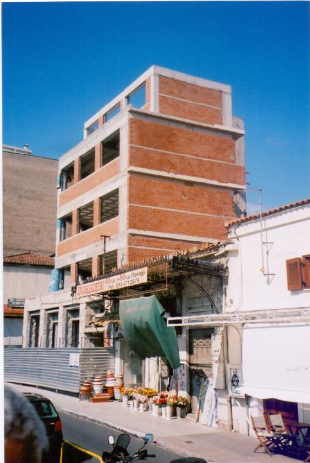
Απαράδεκτη κατασκευή στην υπάρχουσα ακόμη παραδοσιακή όψη της Πλατείας Αγοράς (Οδός Παπαναστασίου).
